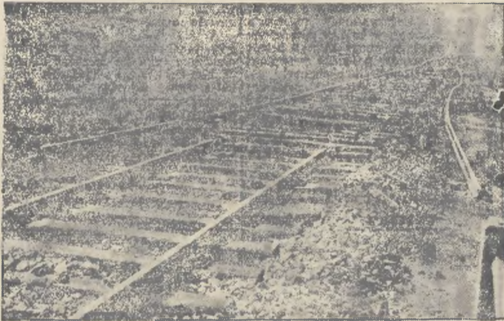
Zniszczony tor kolejowy na pograniczu sudeckim na linii Rumburg — Schoenlinde.
