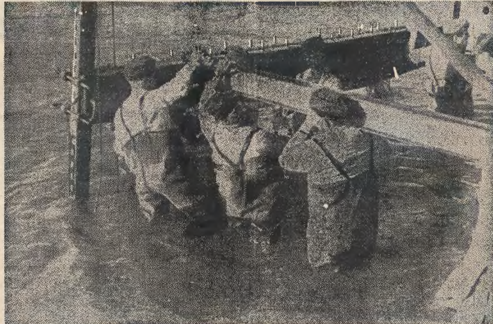
Zdjęcie nasze przedstawia fragment prac pionierów przy budowie pomostu do lądowania. Żołnierze ubrani są w specjalne ubrania gumowe, które chronią ich przed skutkami długotrwałej pracy w wodzie.
