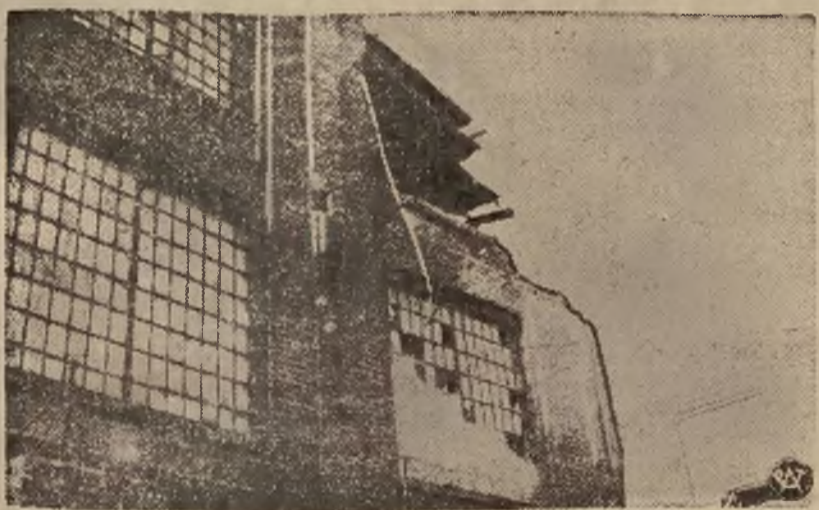
Na zdjęciu naszym widzimy budynek fabryki pończoch F-my Zakrzewski w Łodzi, zrujnowany przez wybuch kotła. Na skutek wybuchu 10 osób zostało ciężko poparzonych.
