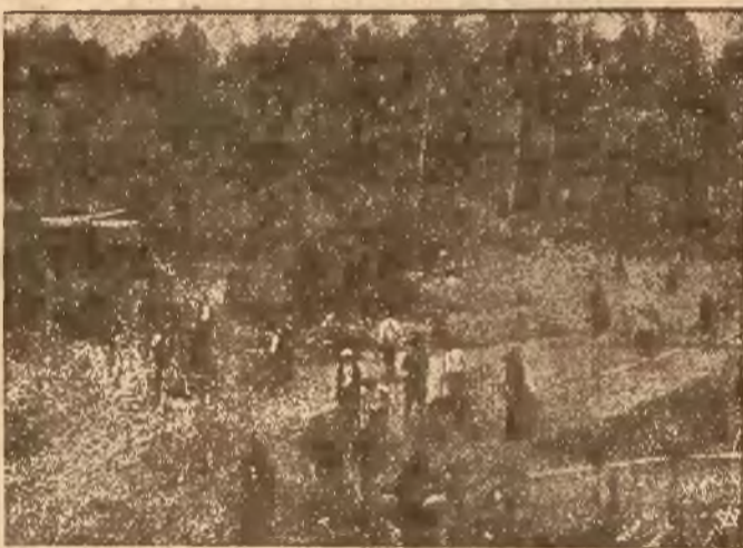
Z nastaniem wiosny zostały wznowione i posuwają się w szybkim tempie prace około budowy Kopca Marszałka Józefa Piłsudskiego na Sowińcu pod Krakowem. Całe rzesze robotników przy pomocy dźwigów mechanicznych przenoszą ziemię do Kopca. Zdjęcie nasze przedstawia fragment robót ziemnych przy Kopcu.
