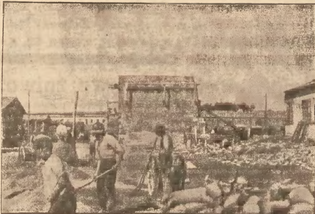
w Asmarze, największym mieście Erytrei. Teren budowy, który widzimy na zdjęciu, był do niedawna pustynią. Przy fabryce będą wybudowane również obszerne domy dla robotników.
