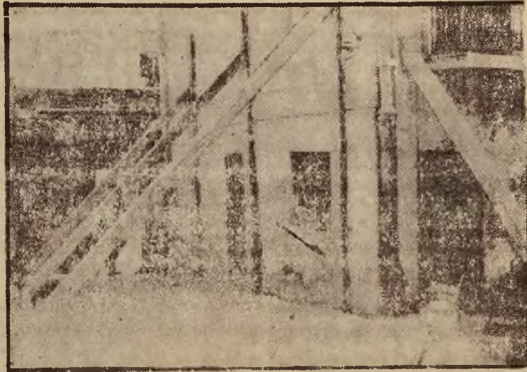
Mały, parterowy domek przy ul. Podwale Nr. 13, podstemplowany od strony podwórza.
