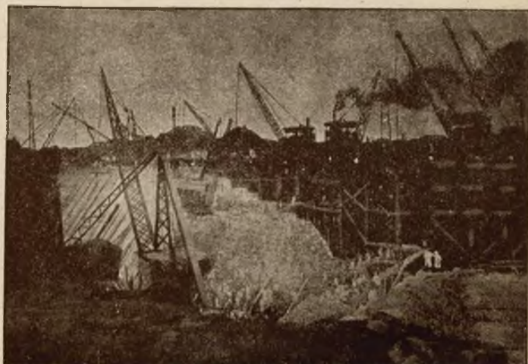
Z krainy Faraonów, w której technicy obecni budują kolosalne tamy przy pomocy gigantycznych żorawi.
