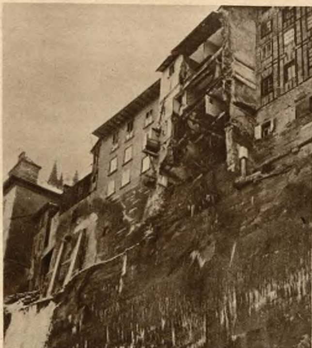
W Fryburgu (Szwajcaria) obsunęła się ściana skalna porywając za sobą frontową ścianę zbudowanego na zboczu domu. Szczęśliwym trafem nieszczęście nie pociągnęło za sobą ofiar w ludziach.
