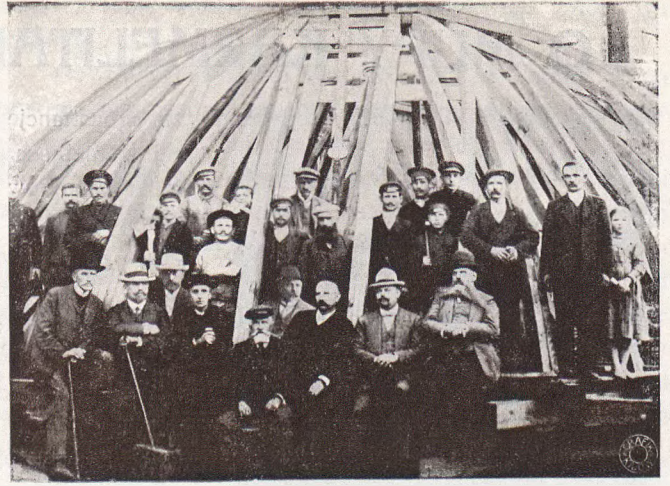
Kościół N. M. P. w Berdyczowie. Komisja wykonawcza robót restauracyjnych na odnawianej wieży kościelnej.
