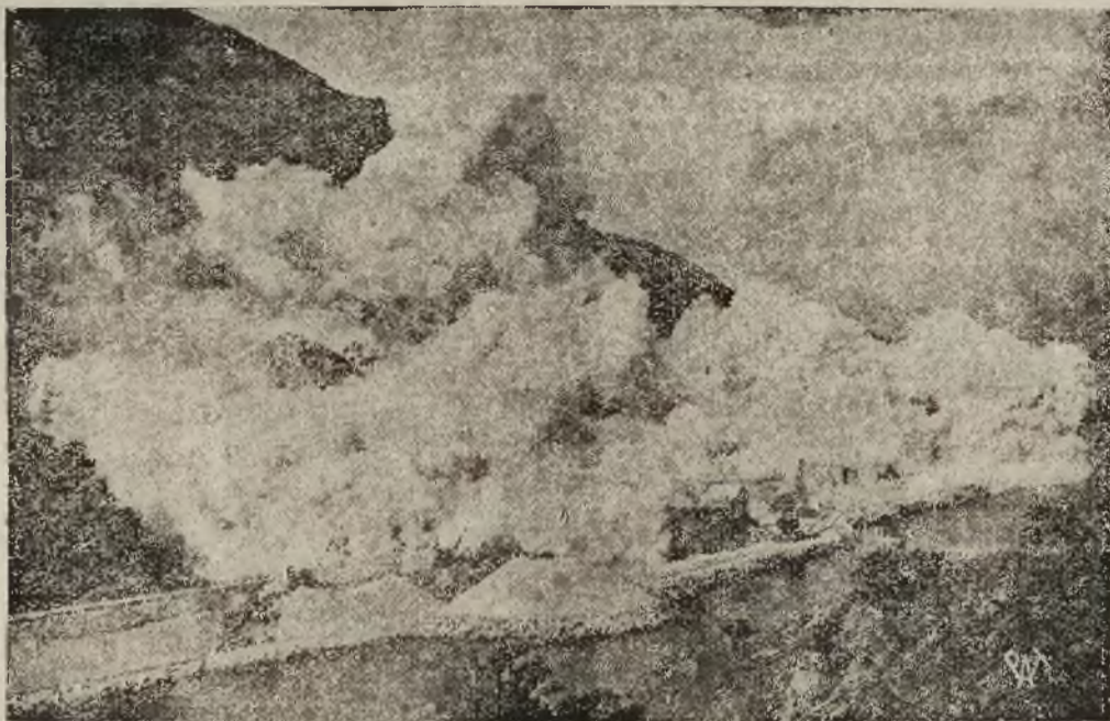
W miejscowości Bonawe (Szkocja) przy budowie jednej z nowych dróg musiano wysadzić w powietrze skałę granitową, objętości blisko miliona ton. Zdjęcie nasze przedstawia moment rozsadzania skały.
