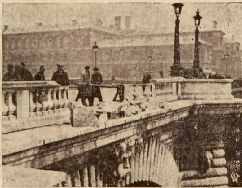
W tych dniach na moście paryskim Notre Dame autobus pragnąc ominąć wóz samochodowy wpadł na kamienną barierę mostu zrywając ją na przestrzeni kilku metrów. Szoferowi udało się jednak w ostatniej chwili zatrzymać wóz dzięki czemu nie doszło do katastrofy podobnej do tej jaka wydarzyła się niedawno pod Sadownem.
