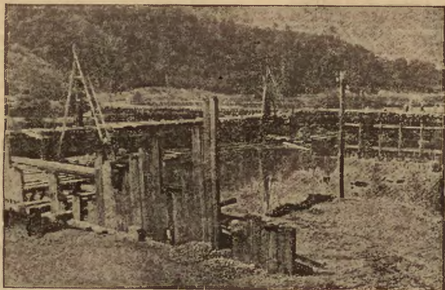
Fragment terenu robót w Turniszkach. Na pierwszym planie budowa jednej ze stacji przelewowych.
