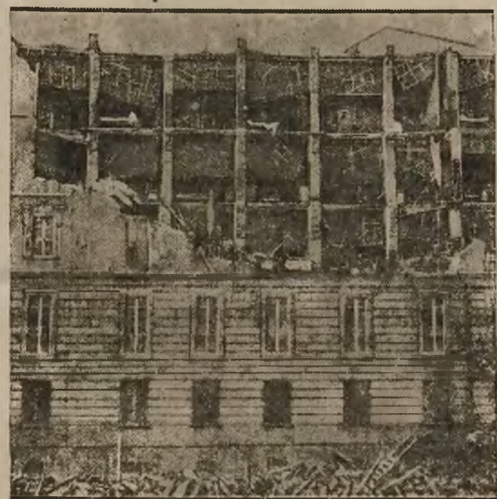
Zerstortes Haus in der Via Casanova in Neapel
