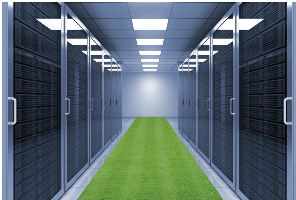
Ilustracja 17. Nowoczesna serwerownia – tak mogą wyglądać archiwa w przyszłości, [dostęp: 3.11.2012], http://www.flickr.com/photos/traftery/4773457853/sizes/o/in/photostream/ .
