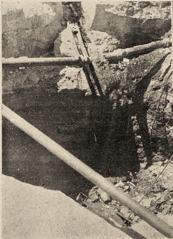
Obnażone przez bombę przewody pod jezdnią.
