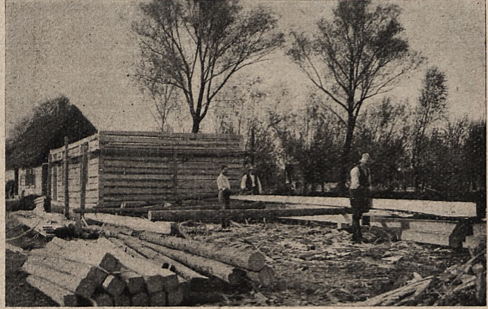
Mikołajowice Już stanęły ściany nowego domu po powodzi. — Wnet będzie i dach nad głową
