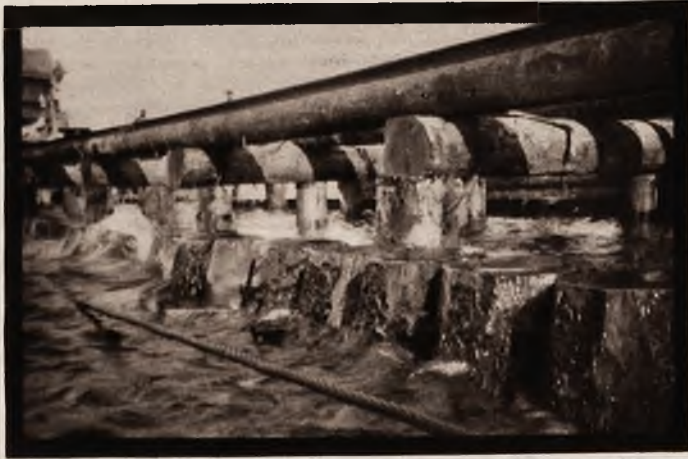
Na lewo: Na pierwszym planie palisada, czyli zewnętrzny rząd pali, które wbito gęsto jeden przy drugim — w głębi pierwsze belkowanie poziome. Fot. R. Burzyński.
