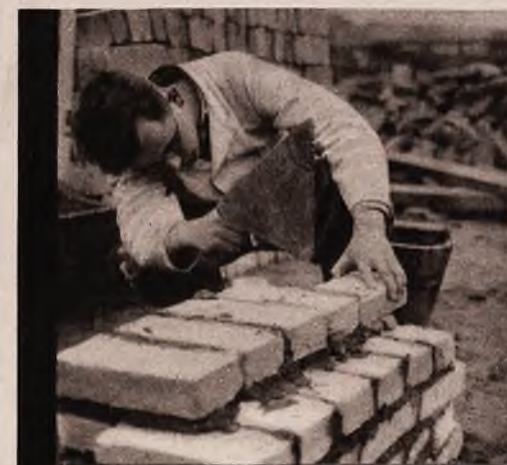
...zawsze wyobrażałem sobie, że fundamenty, to coś skomplikowanego i rozbudowanego wszczepionego pod domem...
