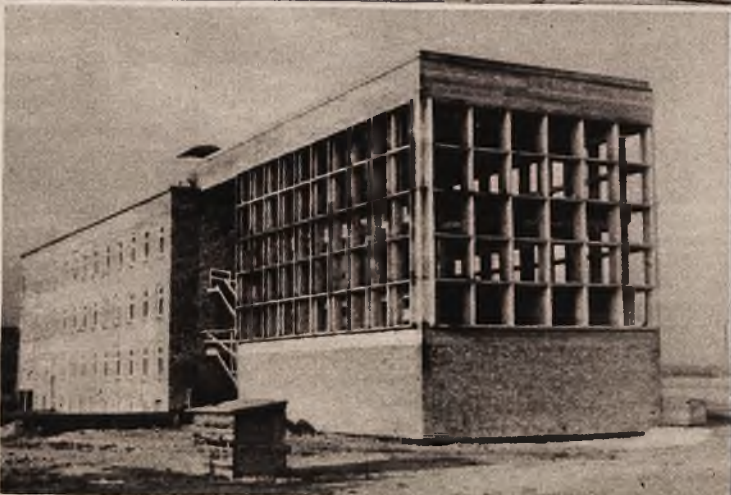
Na lewo: Również stacja morska na molo południowym należy do gmachów, których budowę w dzielnicy reprezentacyjnej już rozpoczęto.
