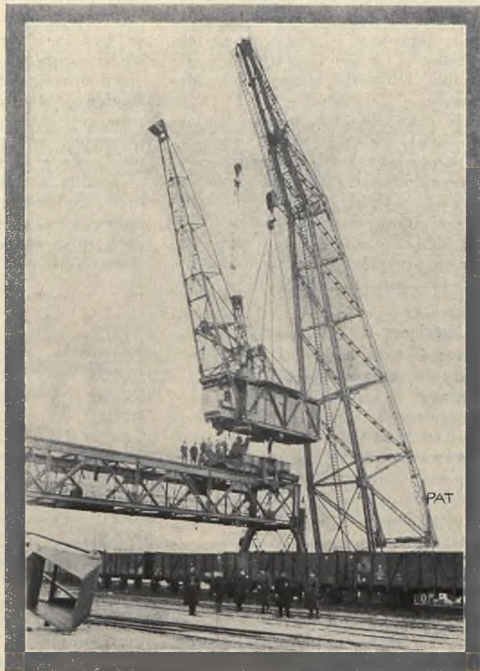
Montowanie nowych dźwigów jest skomplikowane. Olbrzymi pływający dźwig podnosi mniejszy i ustawia na bramic.
