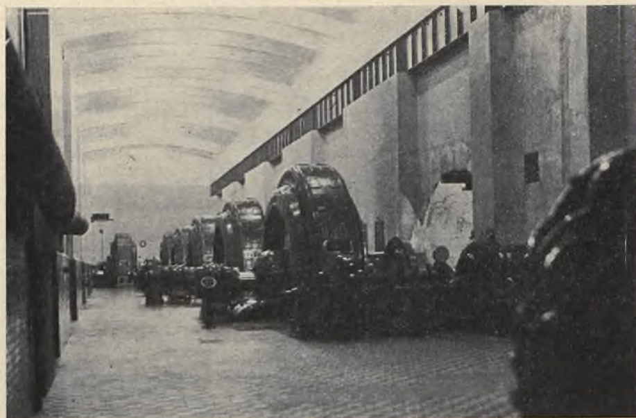
Porjus-Lappland. Hala turbin stacji hydroelektrycznej 50 m. pod pow. ziemi
