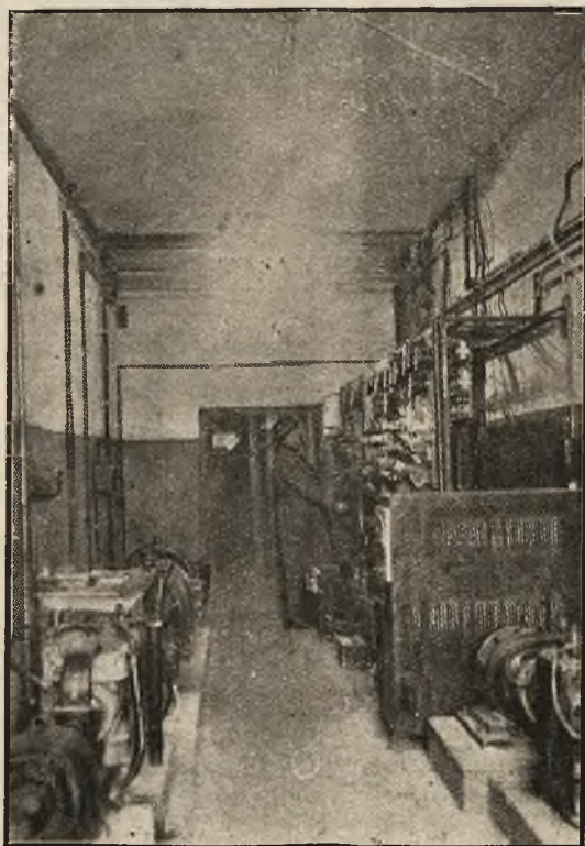
Serce mechaniki „Tudora”, — sala tablic rozdzielczych i dynamomaszyn. Fot. „Autolot”.
