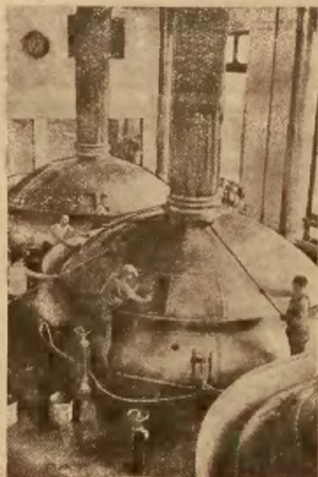
Ilustracja nasza przedstawia remontowanie od 12-tu lat nieczynnego wielkiego browaru w Nowym Yorku, w oczekiwaniu rychłego ograniczenia przez władze prawodawcze St. Zjedn. zakazu wyrobu i spożycia napojów alkoholowych.
