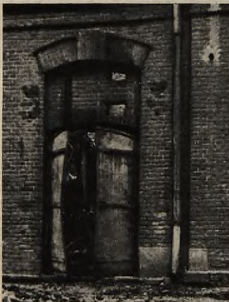
Zewnętrzne drzwi żelazne zniekształcone pod naporem ognia (Zdjęcia autora)
