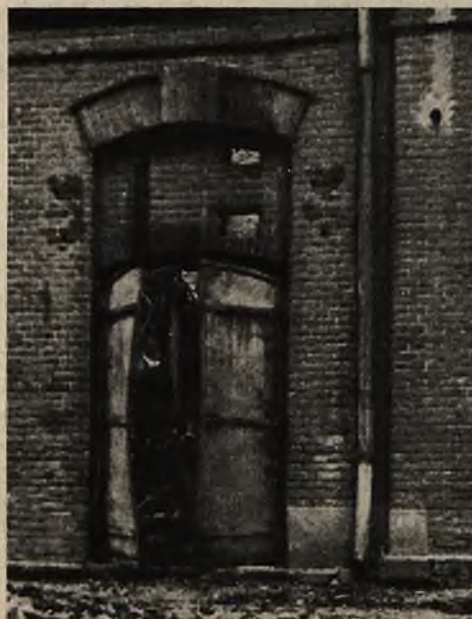
Zewnętrzne drzwi żelazne zniekształcone pod naporem ognia (Zdjęcia autora)
