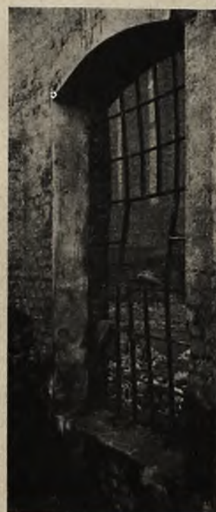
Żelazne okratowanie okien po pożarze
