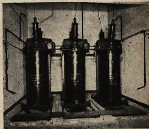
Rys. 7 Kabina z wyłącznikami olejowymi do napięcia 100 kV, zabezpieczona instalacją na dwutlenek węgla
