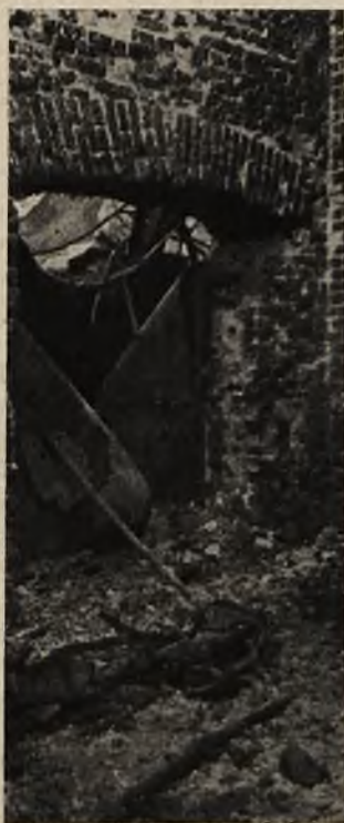
Pojedyncze drzwi żelazne zgięte podczas pożaru
