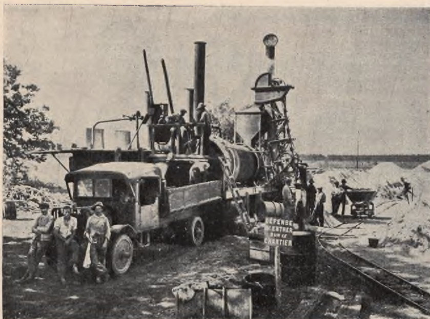
Instalacja do fabrykacji asfaltobetonu systemu „Ejalg” o wydajności 10 ton na godzinę.
