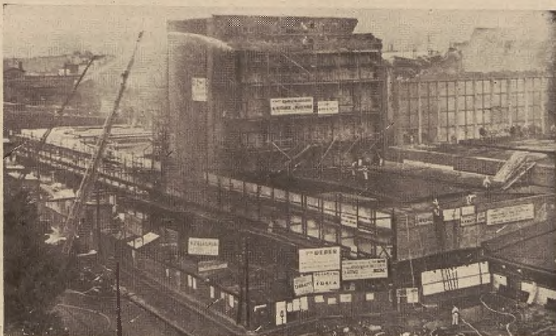
W Warszawie wybuchł w ubiegłym tygodniu olbrzymi pożar niewykończonego dworca Głównego, powodując olbrzymie straty. Na zdjęciu gaszenie płonącego dworca.
