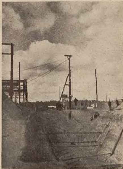
Przewody wysokiego napięcia w Stalowej Woli
