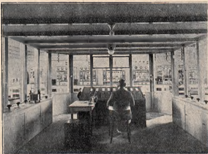
Rys. 2. Urządzenie kontrolne stacji PHOHI.
