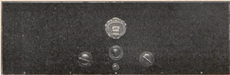
Rys. 8. Zewnętrzny widok płyty rozdzielczej.
