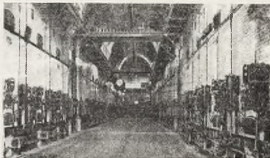
Rys. 8. Wnętrze kotłowni G
