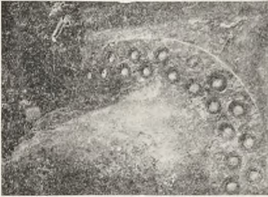
Rys. 1. Podaje wygląd siodła po obcięciu główek nitowych; otwory źle wypełnione; na siodle wypuklina, wskazująca na niedbałe wykonanie
