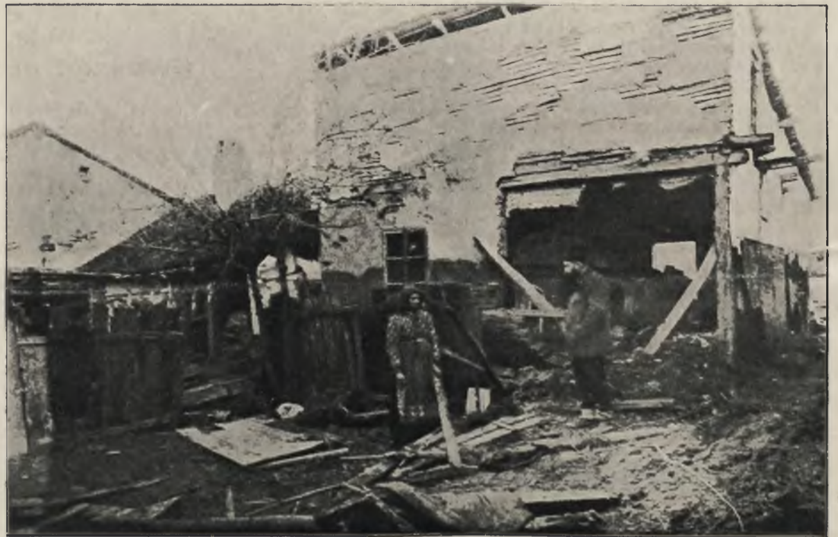
Powódź w Serbii: Zniszczone na przedmieściach Kragujewacu domy, ze śladami wysokości wezbranej wody.
