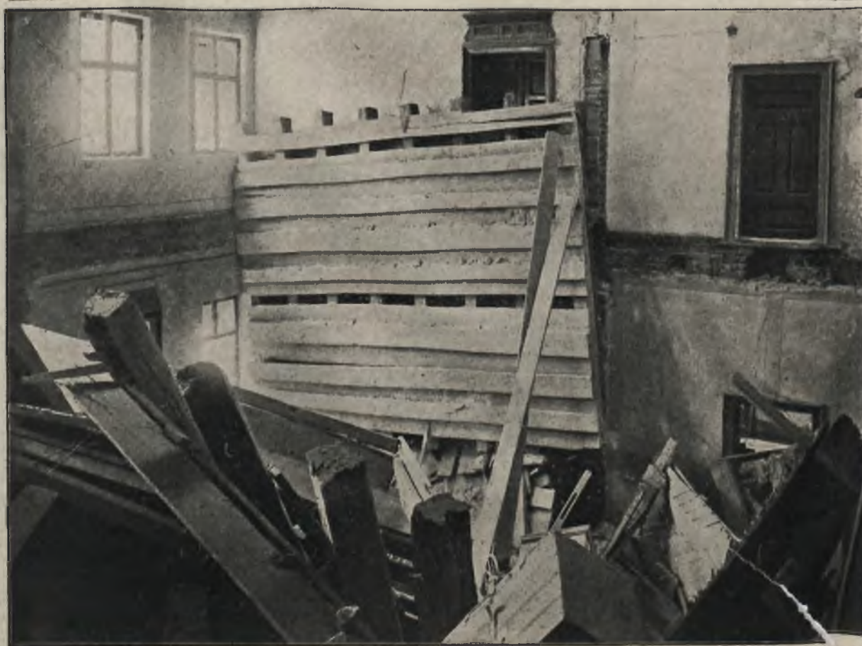
Fot. M. Todt, Przemysł. Katastrofa budowlana w Przemyslu: Wnętrze domu po zawaleniu się ścian bocznych i sufitów.
