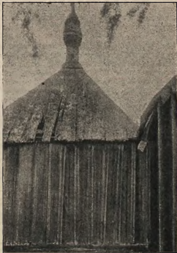
Echa „polowania w cerkwi“: Uszkodzony dach cerkwi.
