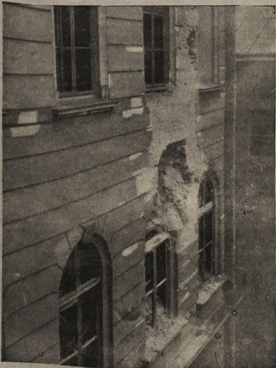
Uszkodzony gmach sądu wyższego karnego.
