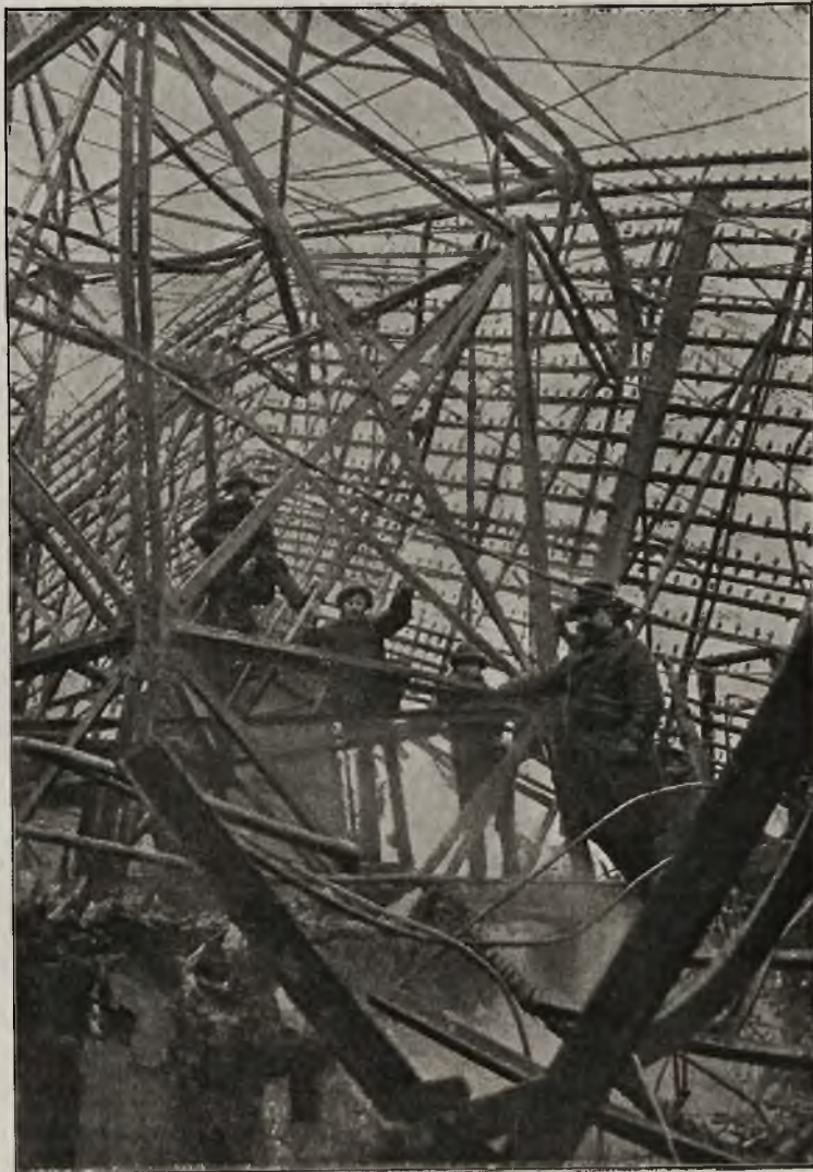
Pożar stacji telefonów w Antwerpii: Wieża z rusztowaniem przewodów telefonicznych po pożarze.
