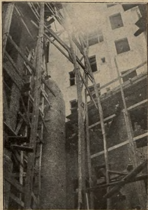
Katastrofa budowlana w Warszawie: Miejsce katastrofy w domu na rogu ul. Złotej i Sosnowej.
