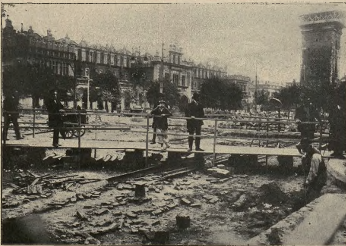
Rozkopany Kraków: Układanie nowych szyn tramwajowych na Rynku u wylotu ulic Szczepańskiej i Sławkowskiej.
