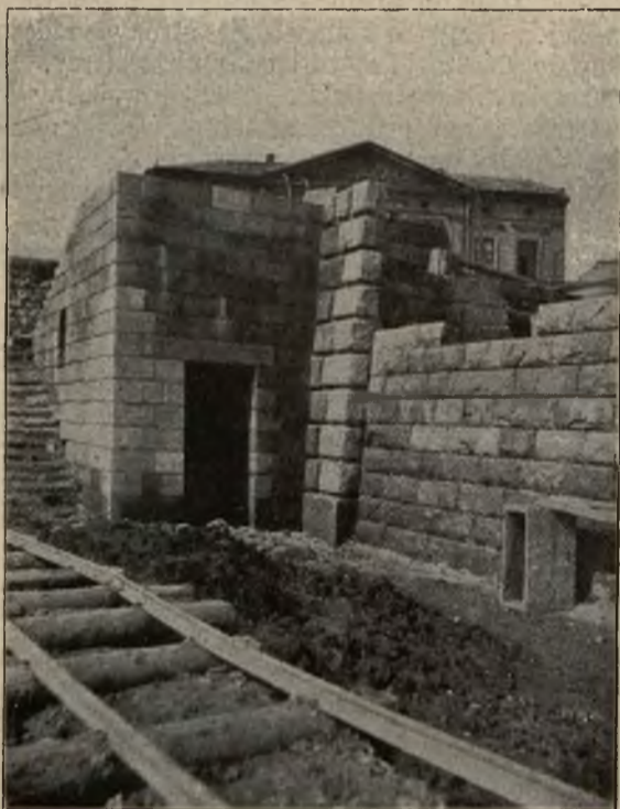
Bulwary kanałowe nad Wisłą w Krakowie: Przyczółek nowego czwartego mostu po stronie krakowskiej.
