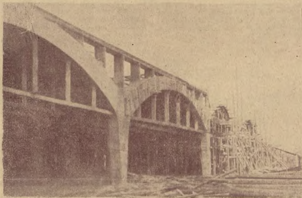
Budowa polsko-francuskich warsztatów samochodowych i lotniczych: Garaże i hale warsztatowe w trakcie budowy.
