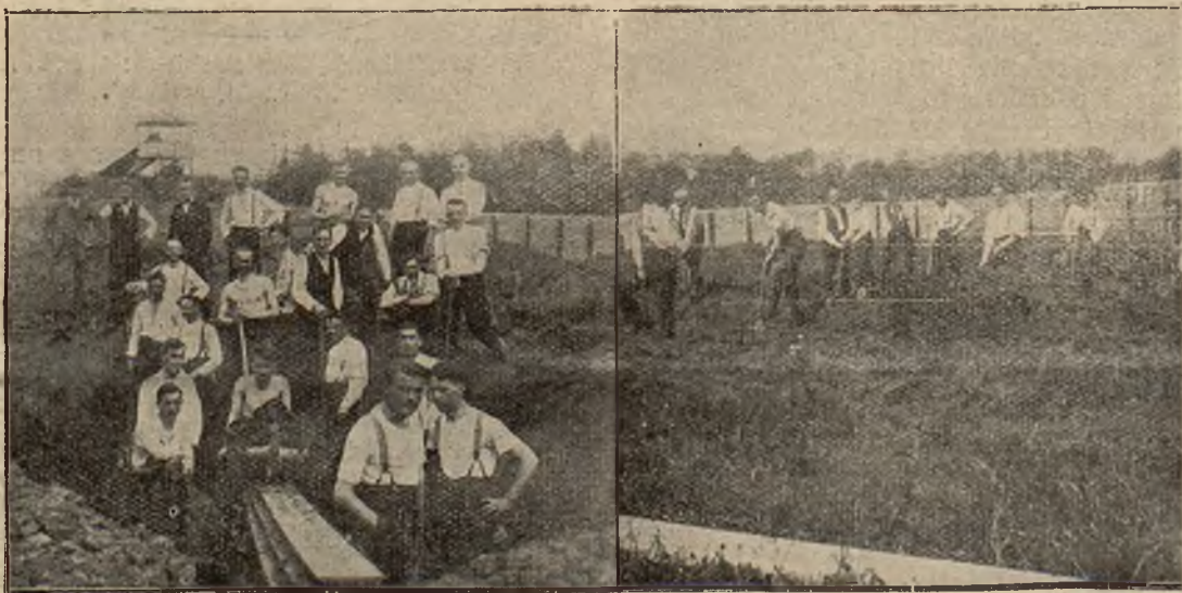
Budowa domu akademickiego w Krakowie: Studenci przy pracy nad wzniesieniem swego przyszłego ogniska.
