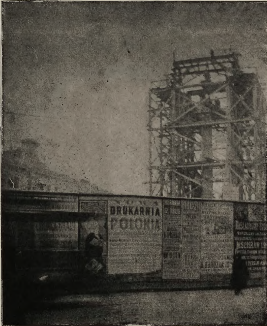
Geniuszowi poety – miasto Lwów: Prace przy ustawianiu kolumny Adama Mickiewicza na placu Maryackim.
