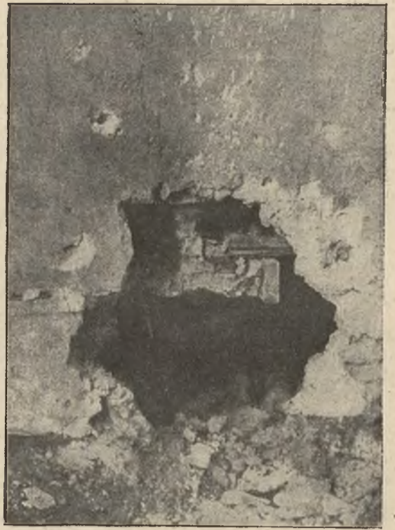
Walka z apaszami: Zburzona wybuchem bomby ściana „fortecy” paryskich bandytów Garniera i Valleta.
