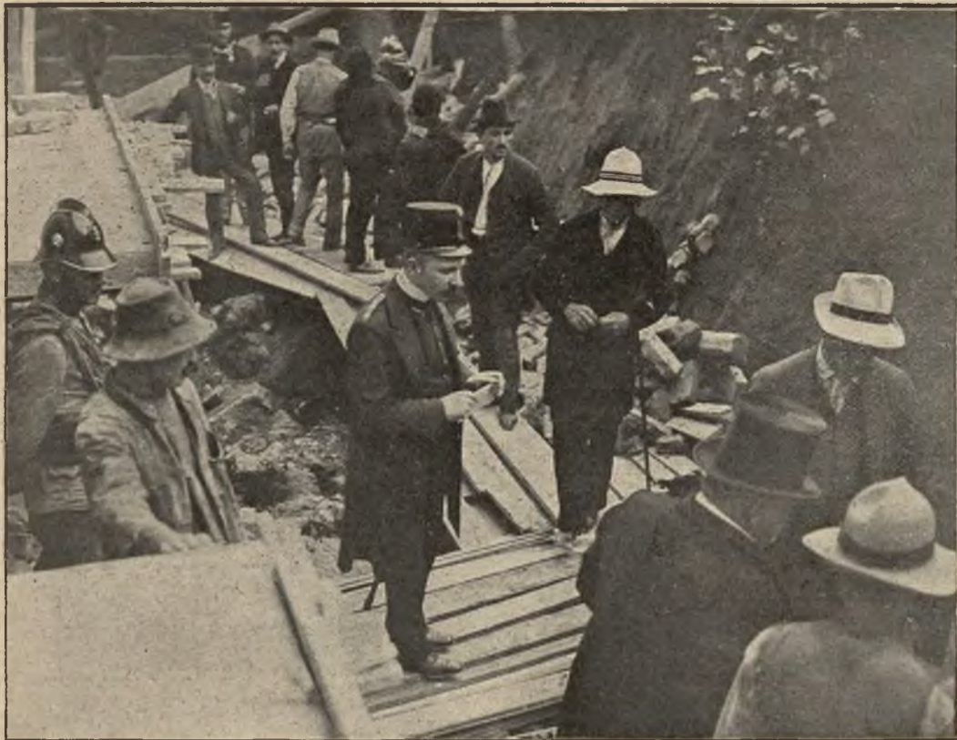
Znowu katastrofa budowlana we Lwowie: Odkopywanie zasypianych robotników. (Fot. M. Münz, Lwów).
