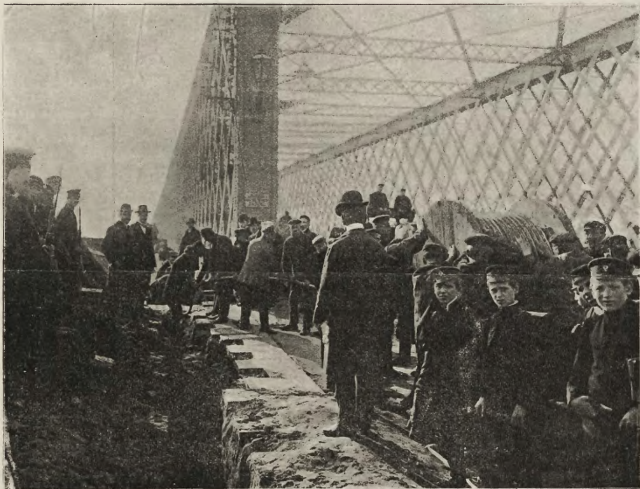
Budowa tramwajów pod ochroną wojskową: Przerabianie linii tramwajów konnych w Warszawie na elektryczne pod osłoną patroli wojskowych ze względu na ciągłe strejki; układanie i montowanie kabli na moście.
