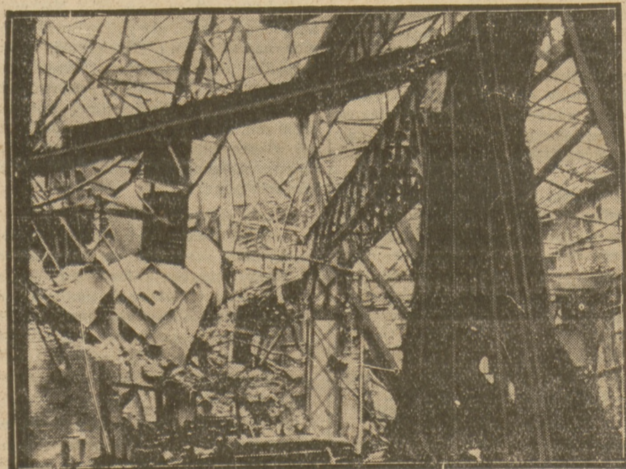
Fabryka po katastrofie przedstawia żałosny widok.
