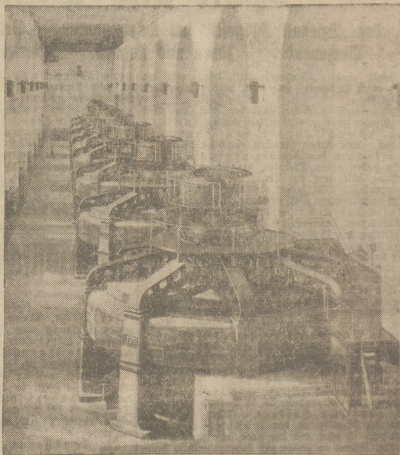
Maschinenhalle eines modernen Wasserkraftwerkes.
