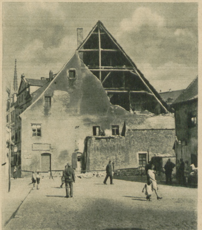
Wirbelstürme haben in letzter Zeit an manchen Stellen Deutschlands großen Schaden angerichtet. In Freiberg i. Sa. wurde bei einem nächtlichen Sturm ein ganzer Hausgiebel abgerissen. Glücklicherweise wurde niemand dabei verletzt. König, Freiberg i. S.
