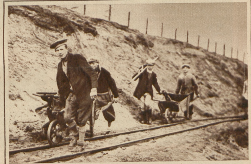
Der Verein für Radfahrwege in Berlin hat mit Unterstützung der Arbeitsämter eine Art freiwilligen Arbeitsdienst eingerichtet, durch den Arbeitslose gegen ganz geringen Entgelt zur Anlage von Radfahrwegen herangezogen werden.
